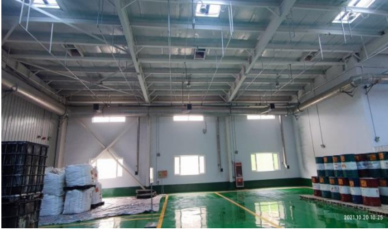
危废储库废气集气口
