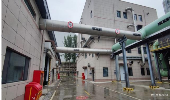
危废预处理楼废气集气管
