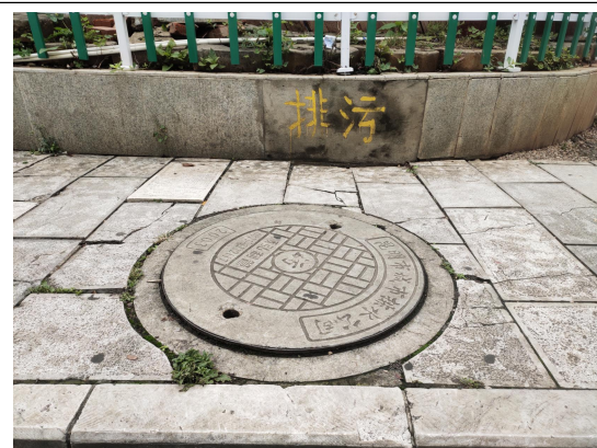
十六、污水总排口
