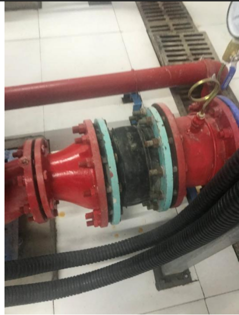
消防泵软连接
