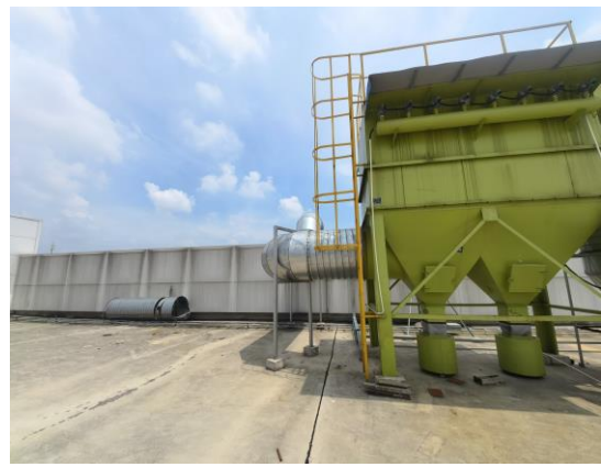
焊接烟尘、打磨粉尘：滤筒除尘器
