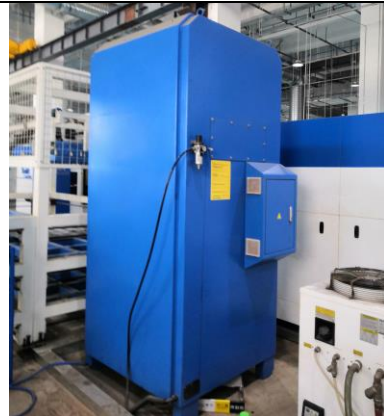
切割粉尘：滤筒除尘器
