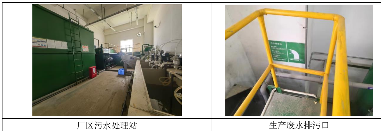
图4 废水治理措施
