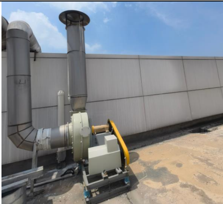
天然气燃烧废气：15m 排气筒
