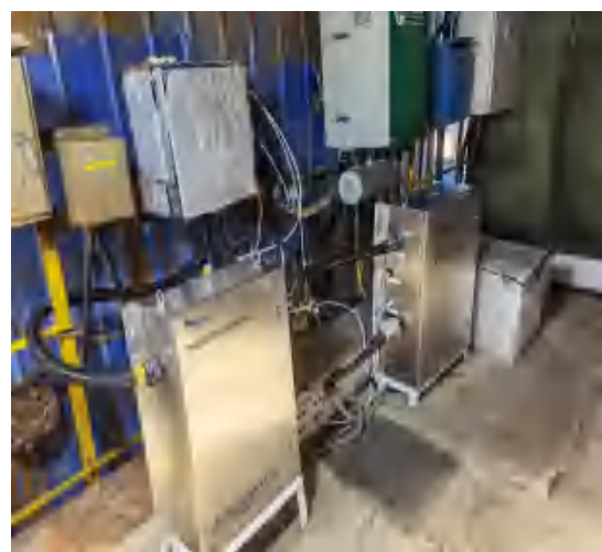
除湿、除氨预处理系统主机
