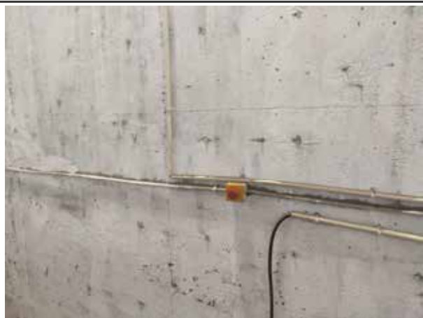
北墙中部急停按钮
