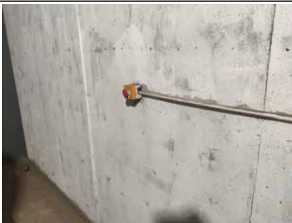
西墙中部急停按钮
