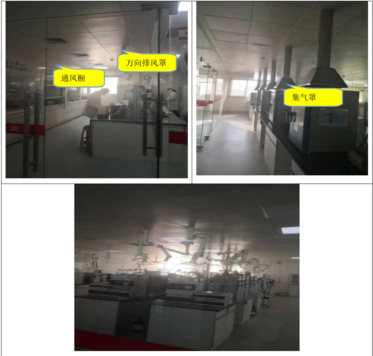
图 4-1 实验室集气罩及集气管道
