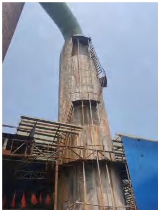
隧道窑脱硫塔
