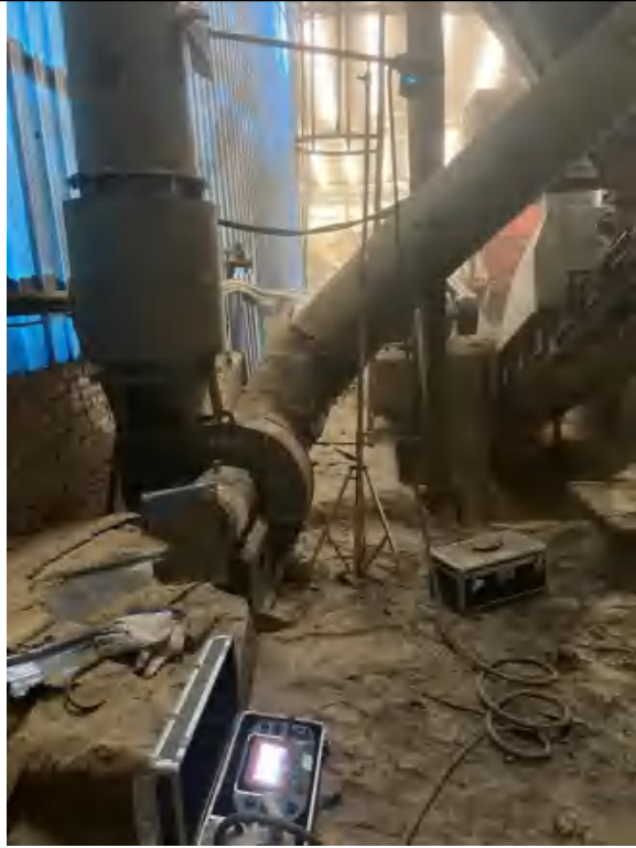
布袋除尘排气筒检测
