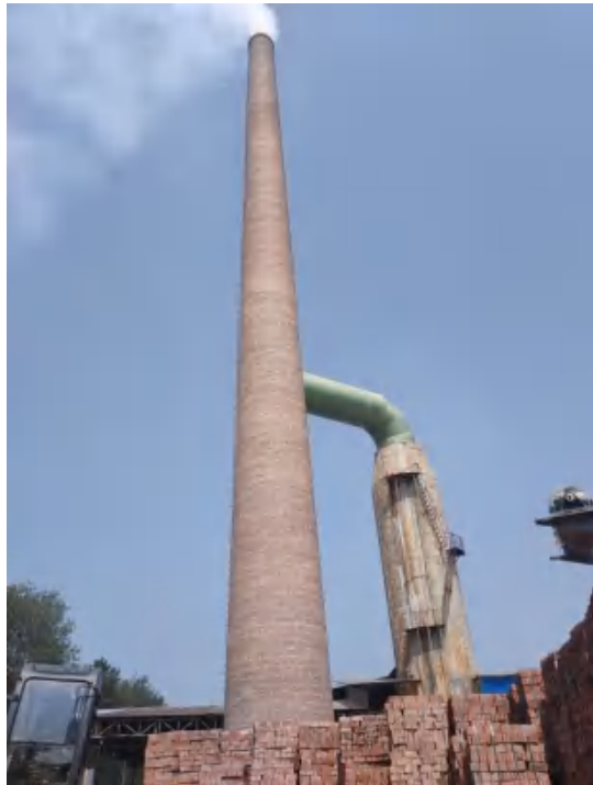
窑炉废气排气筒及脱硫塔
