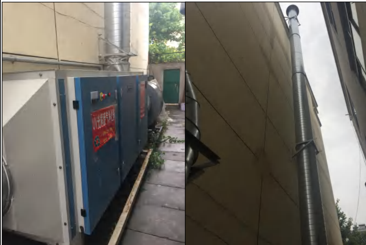
废气处理设施
