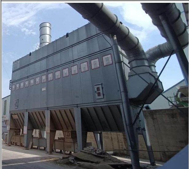
中央布袋除尘器
