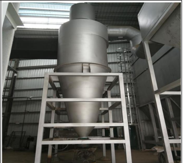
锅炉旋风除尘器
