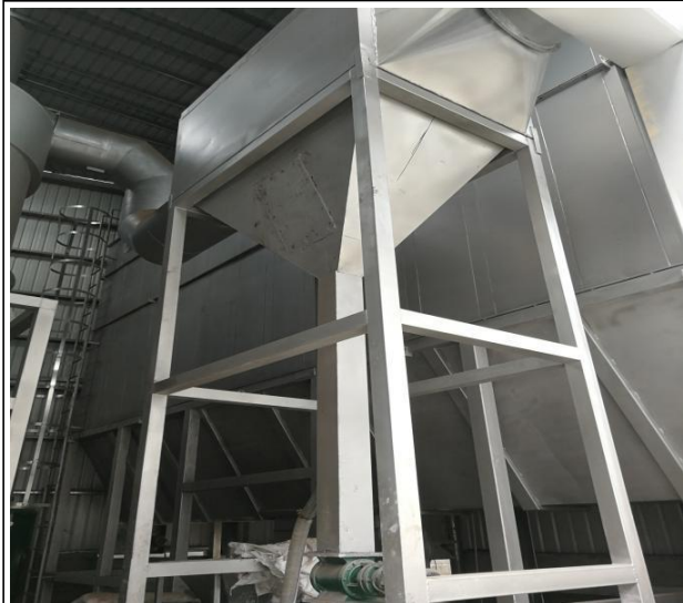
锅炉脉冲布袋除尘器
