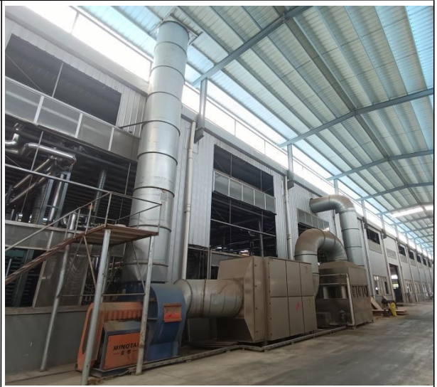
水喷淋+三级活性炭+UV 光解废气装置
