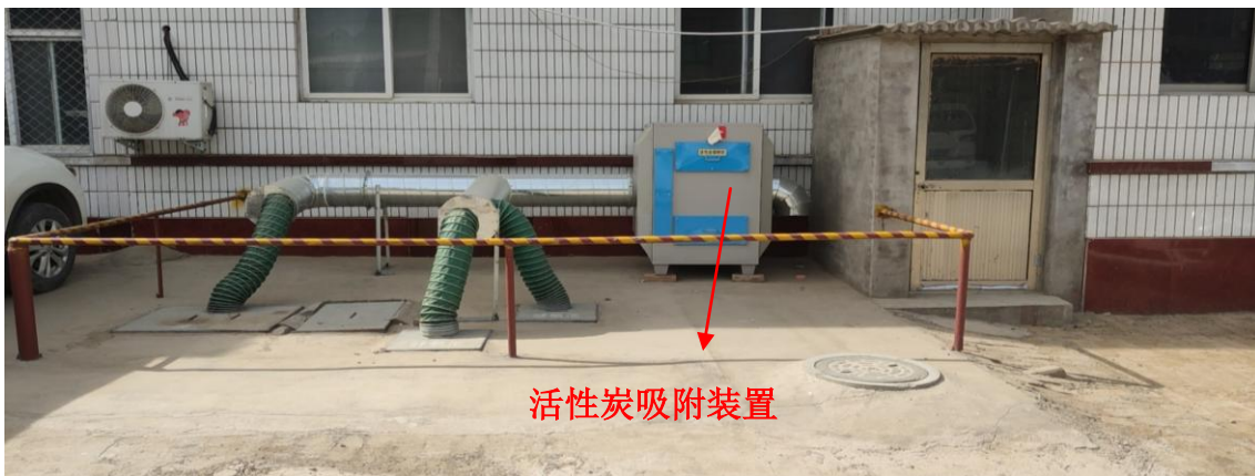
图 4-3 废气治理设施
