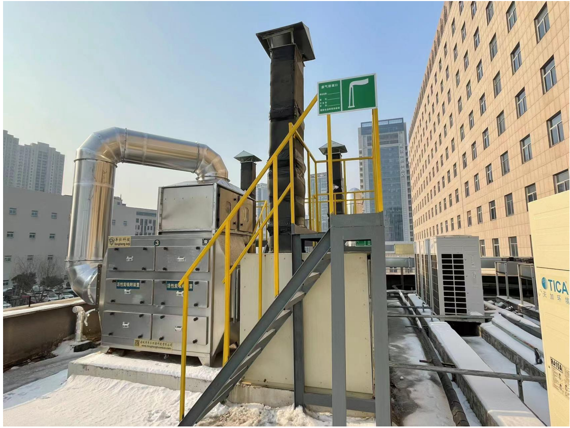
图7-1 废气处理设备
