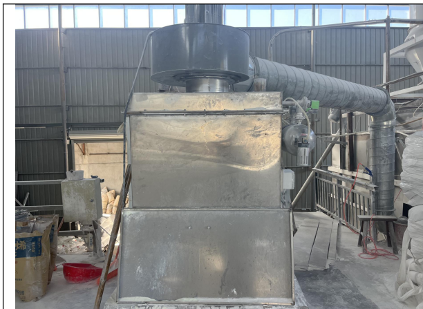
投料粉尘处理设施
