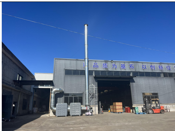
挤出、注塑废气处理设施
