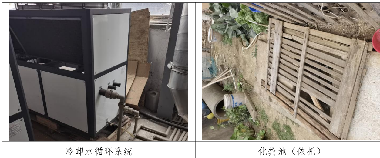
图 4-1 项目废水处理设施
