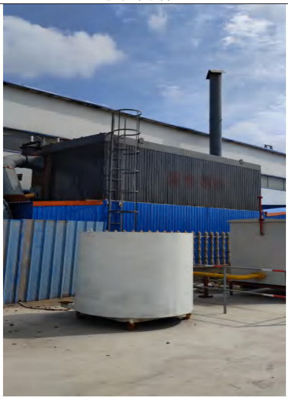
沸腾炉布袋除尘器+Y4 排气筒
