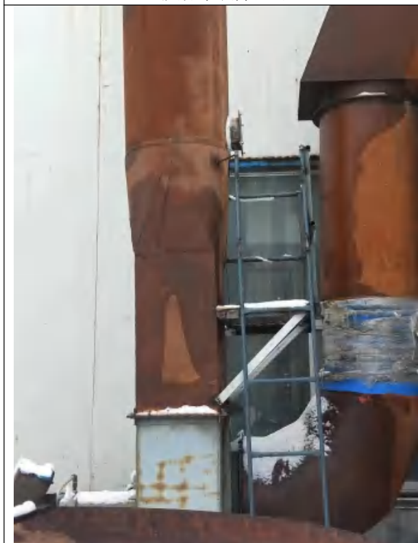
皮带秤布袋除尘器+Y3 排气筒+采样平台
