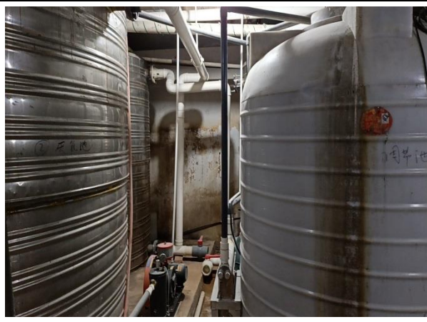
污水处理站设备间
