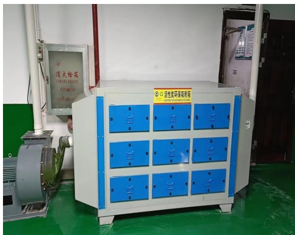
污水处理站废气处理设施
