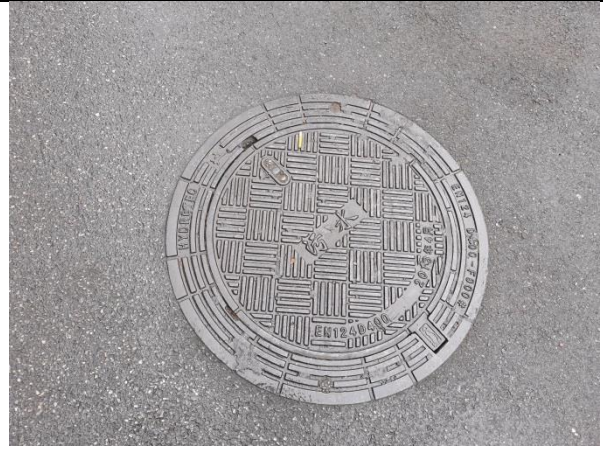
项目接入市政污水管网
