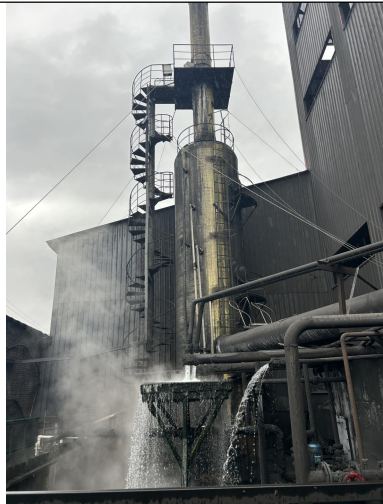
单碱法脱硫塔
