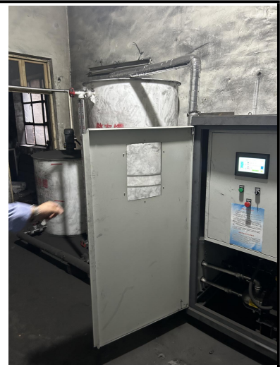
SNCR脱硝设施
