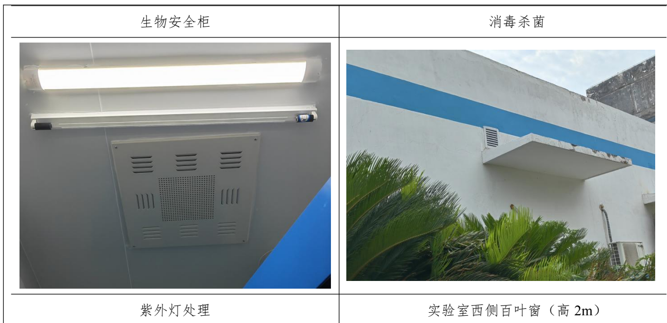
图 4-3 项目废气处理设施
