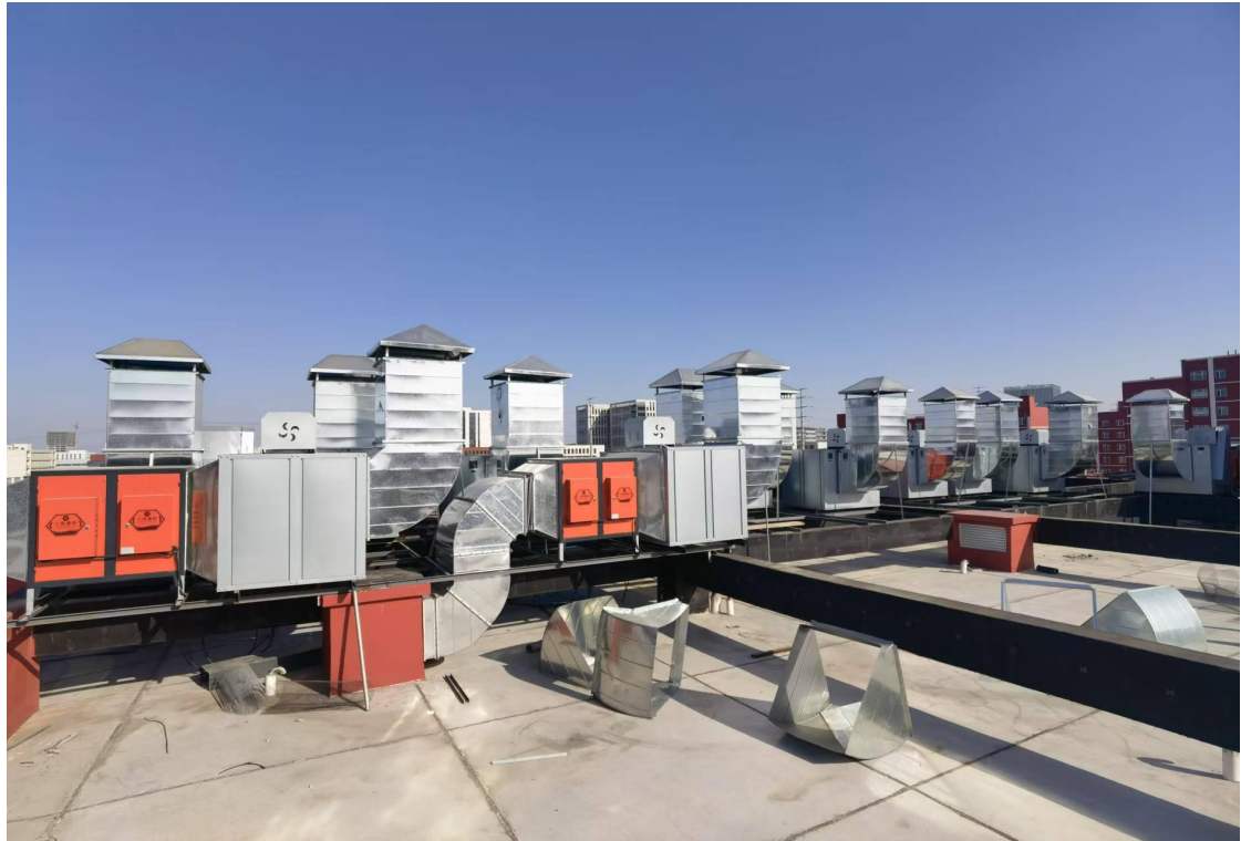
图7-1 废气处理设备
