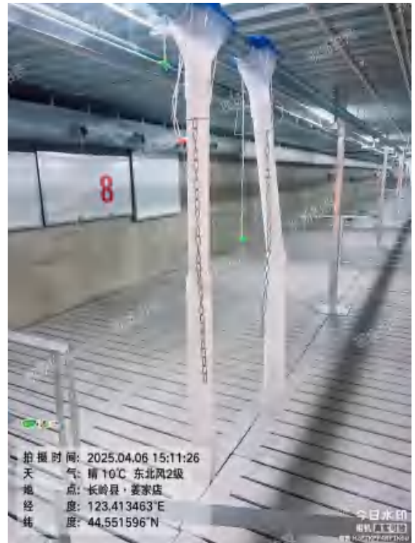
30 场猪舍漏缝地板
