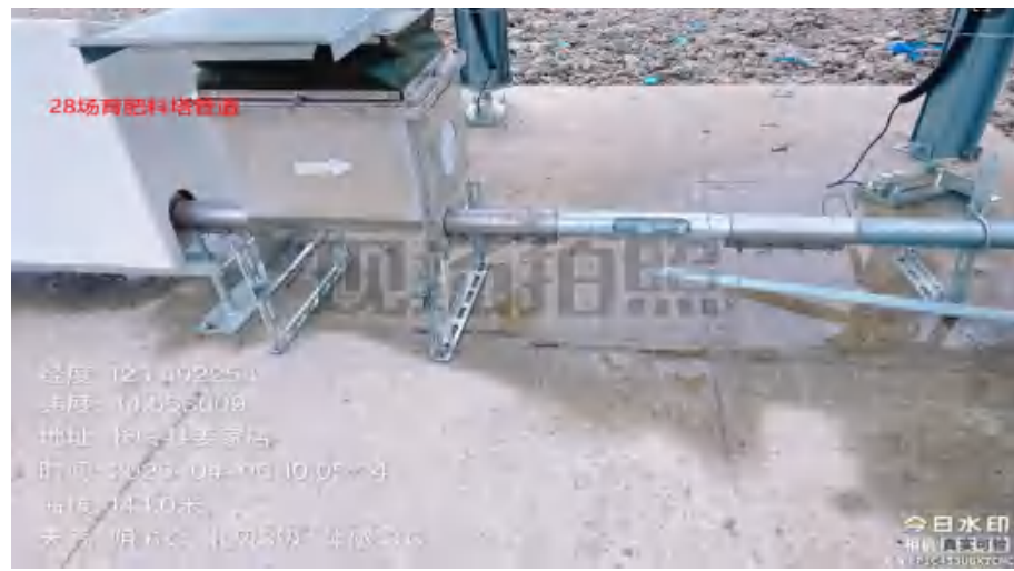
28 场饲料输送管道密闭
