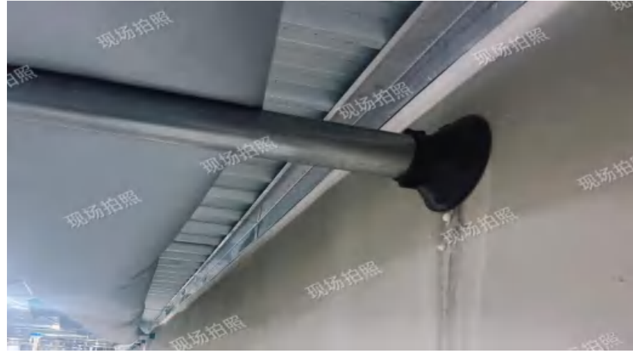
30 场饲料输送管道密闭
