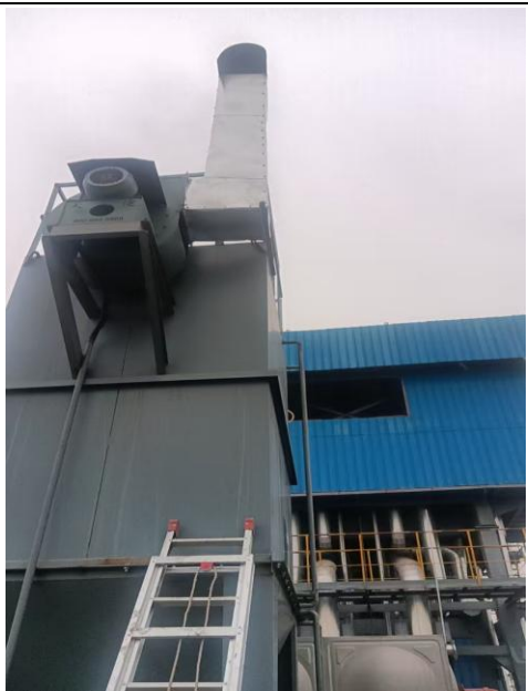
输料带顶部除尘器
