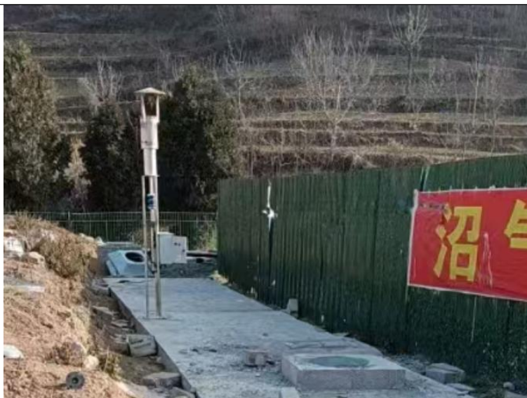
火炬燃烧装置
