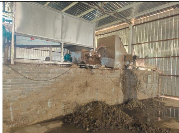
干湿分离间内的集污池
