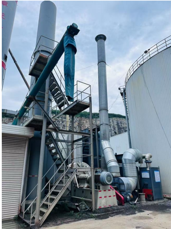
图7-2 废气处理设备
