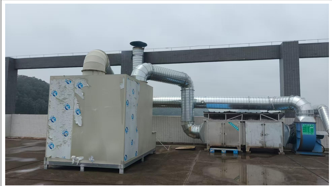
1套“水喷淋+脱水除雾+两级活性炭吸附装置”
