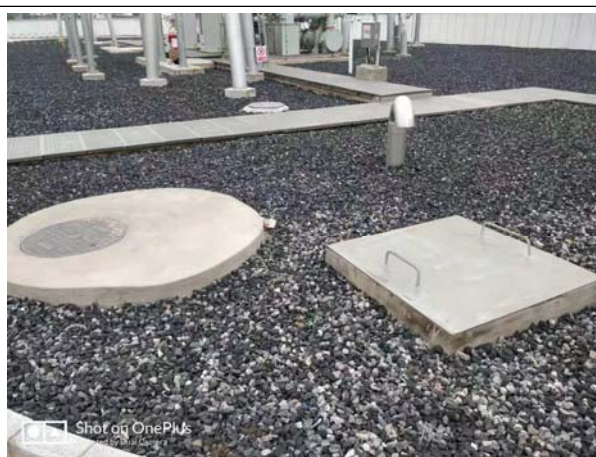
站内事故油池
