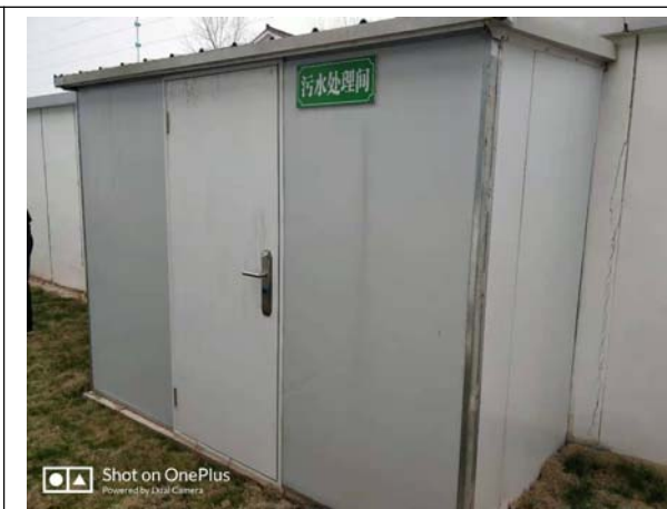
站内生活污水处理区
