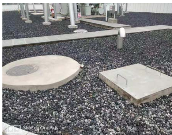
站内事故油池
