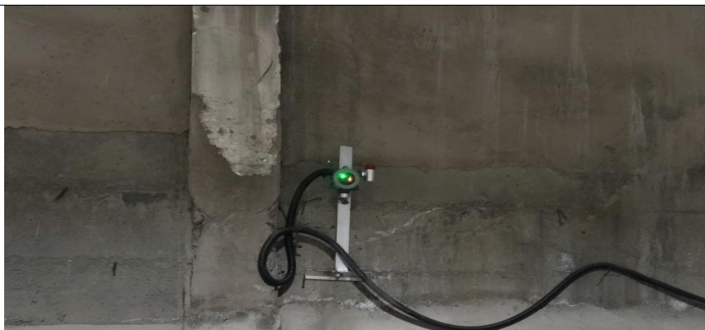
建成后危险废物专用库房内废气浓度自动监测装置
