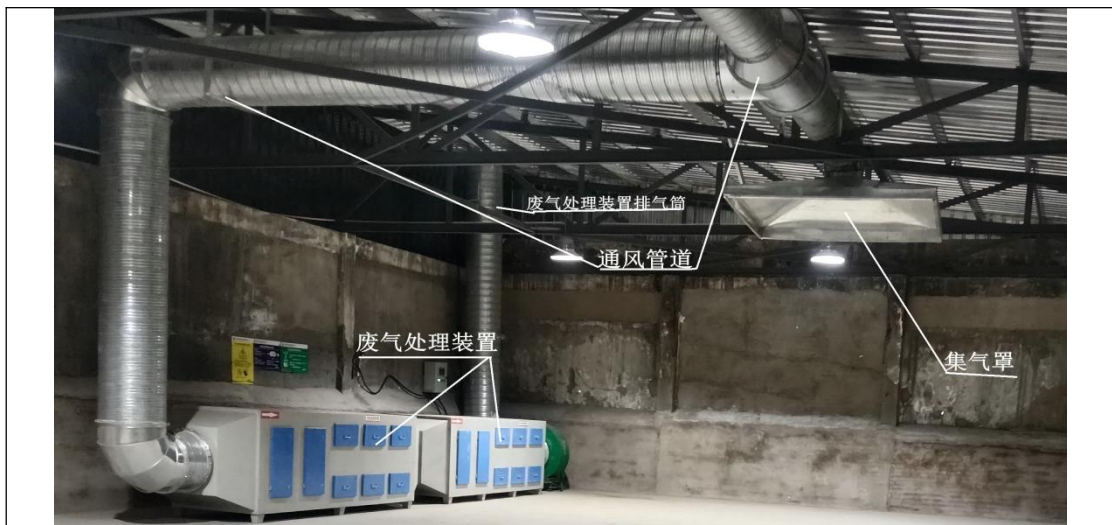
危险废物专用库内废气收集处理装置（1）
