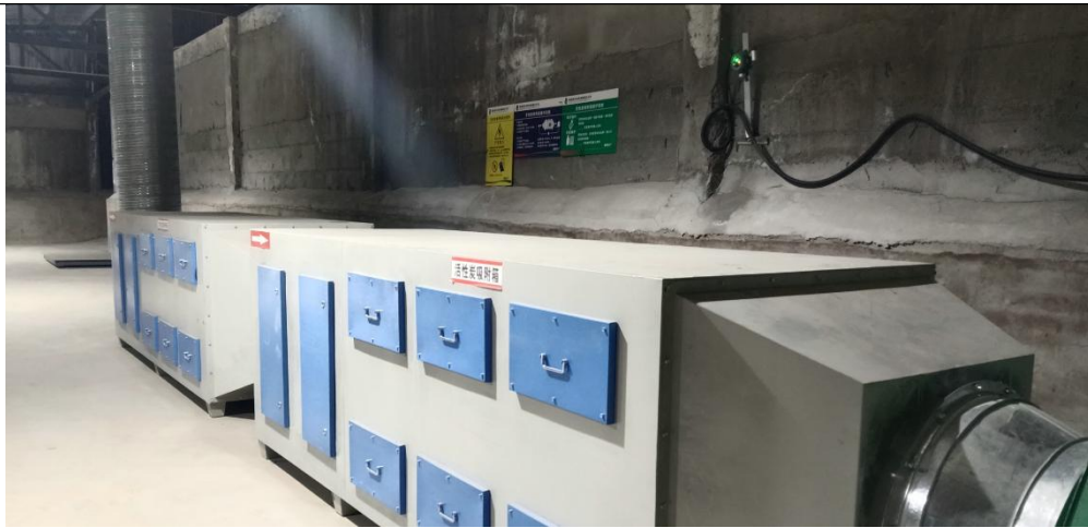
危险废物专用库内废气收集处理装置（2）
