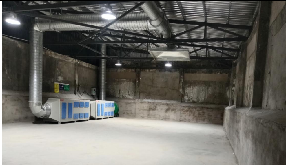
危险废物专用库房建成后内部情况
