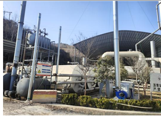
沥青烟处理装置 15m 高排气筒
