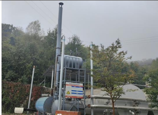
导热油炉 8m 高排气筒
