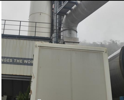
燃烧、干燥、筛分工段布袋除尘器
