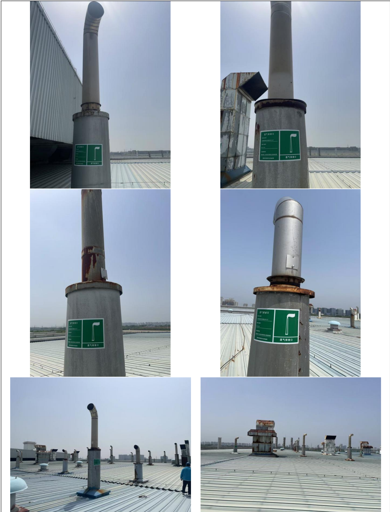
天然气燃烧废气排气筒 图 4-2 废气处置设施现场图
