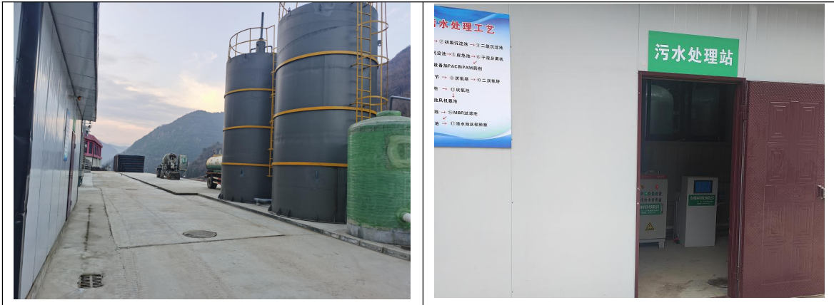
一体化地埋式污水处理站
