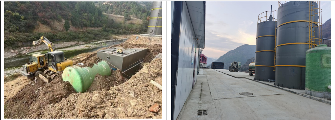
一体化地埋式污水处理站
