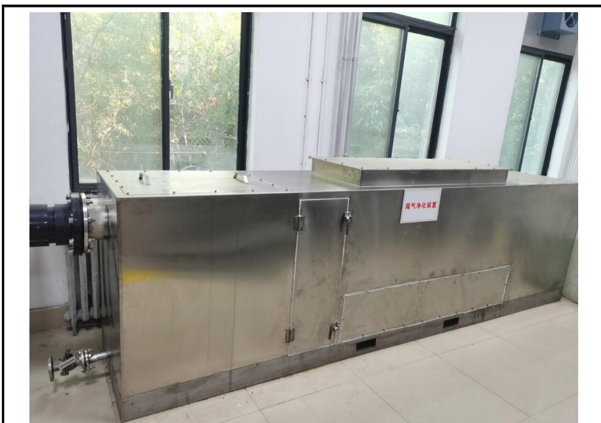
图7-2 废气处理设备
