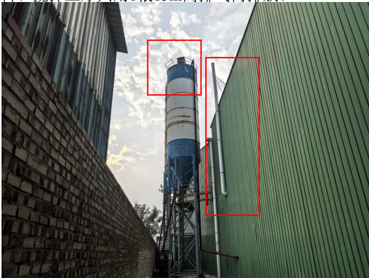
仓顶除尘器+排气筒
