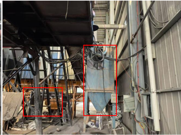
受料口下方集气罩+布袋除尘器
