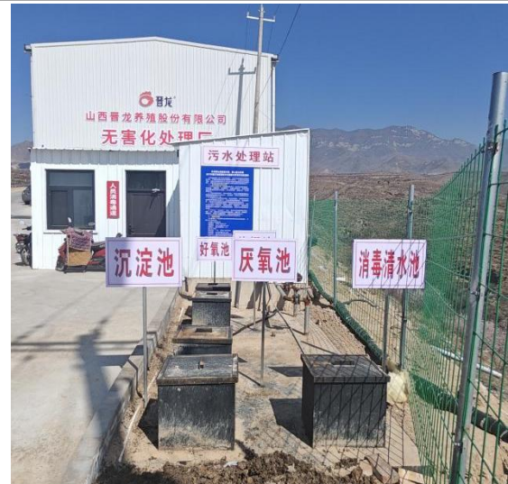
地埋式污水处理站
