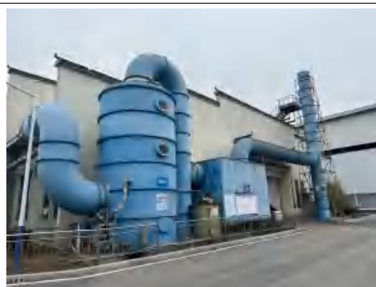
废气喷淋装置
