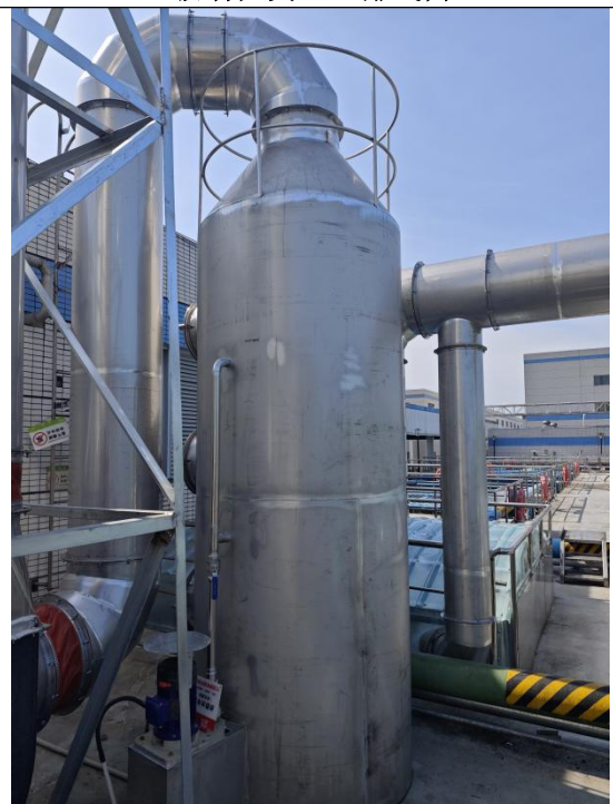
碱喷淋 (2#排气筒)
