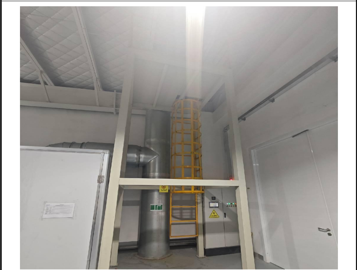
图7-1 废气处理设备
