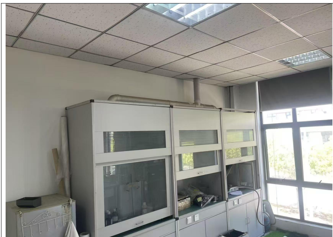
通风柜废气收集现状
