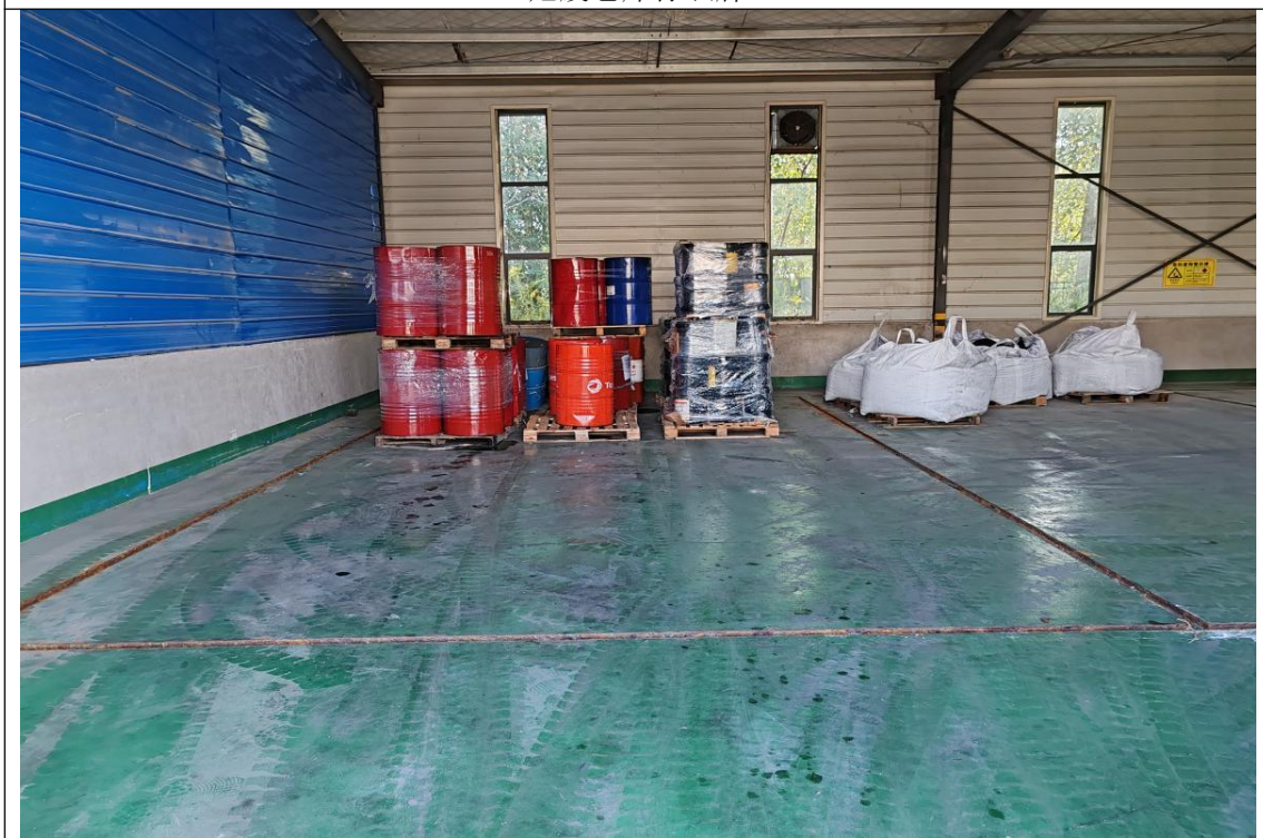
危废仓库分区及地面导流槽
