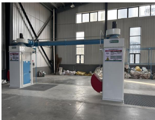
进料口脉冲除尘器
