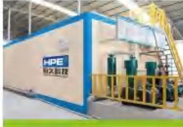
污水处理站（图二）
