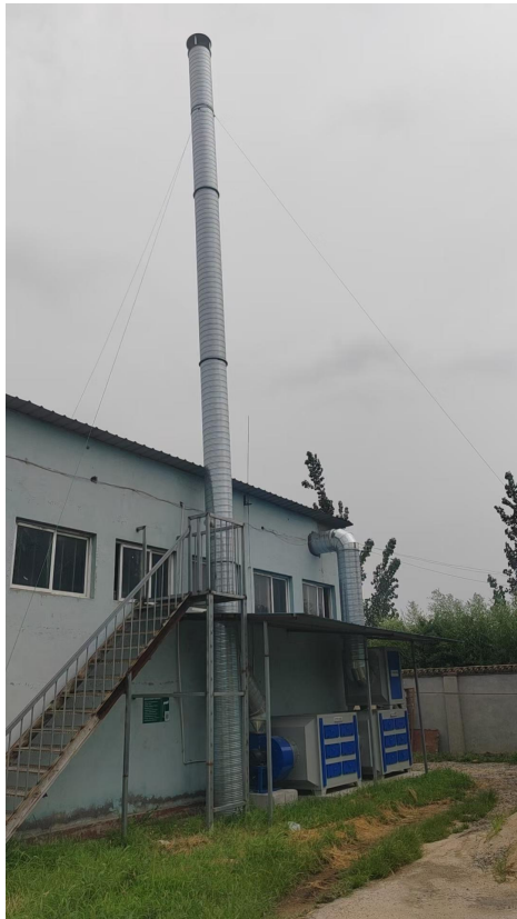
图7-2 废气处理设备
