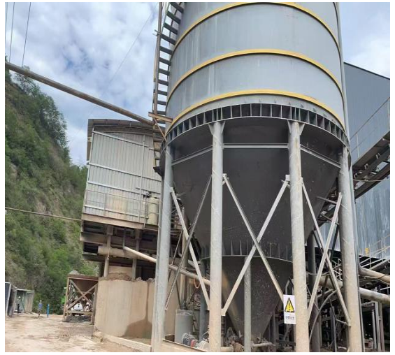
项目絮凝沉淀罐
