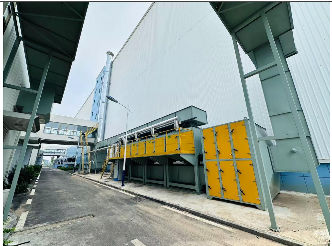
图7-1 废气处理设备
