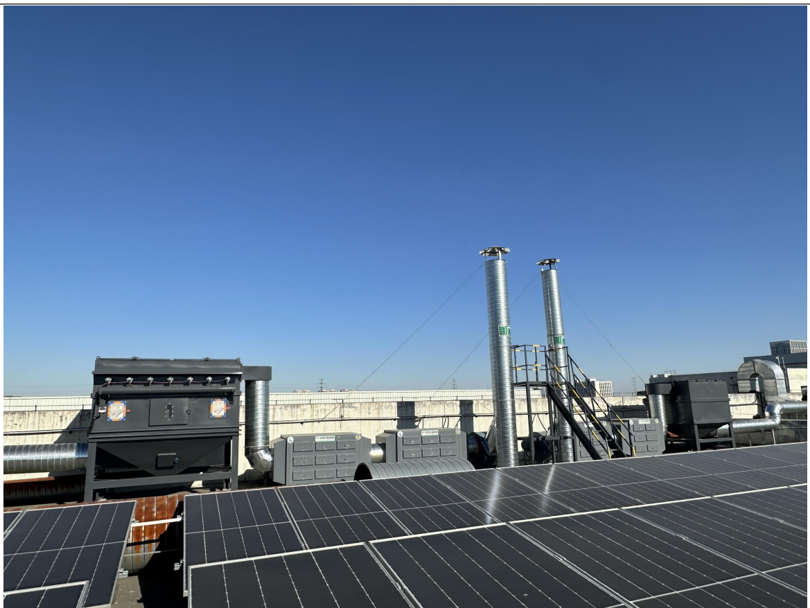
图7-1 废气处理设备
