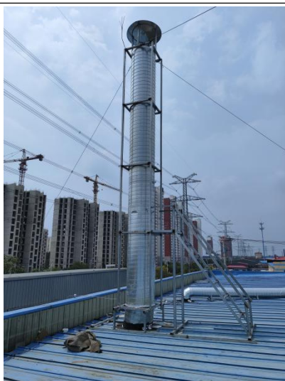
P3 排气筒采样口
