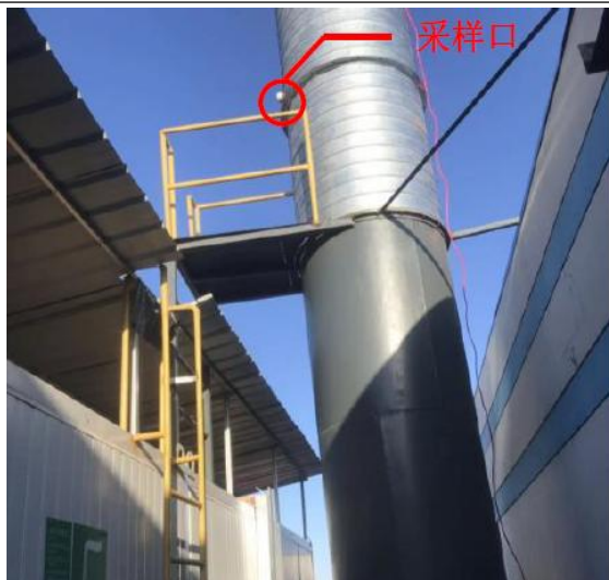
P2 排气筒采样口
