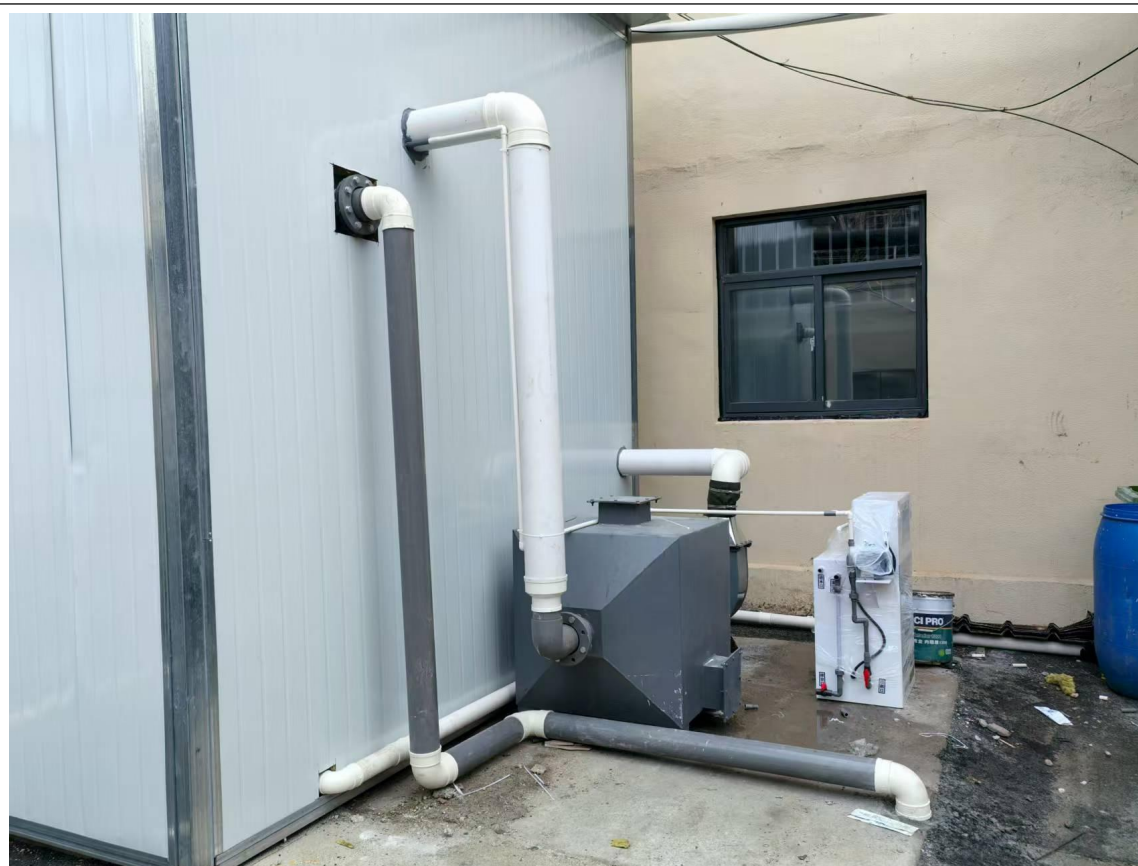
图7-1 废气处理设备
