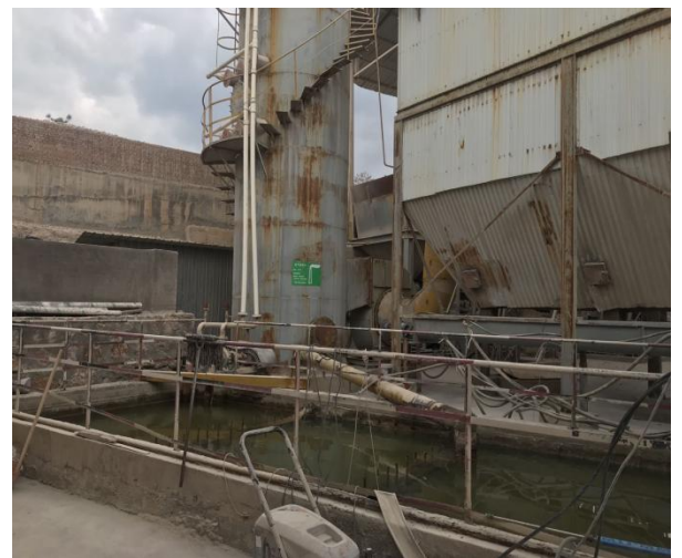
照片 4：循环沉淀池 1#
