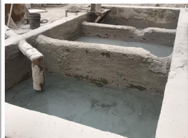
照片 5：循环沉淀池 2#
