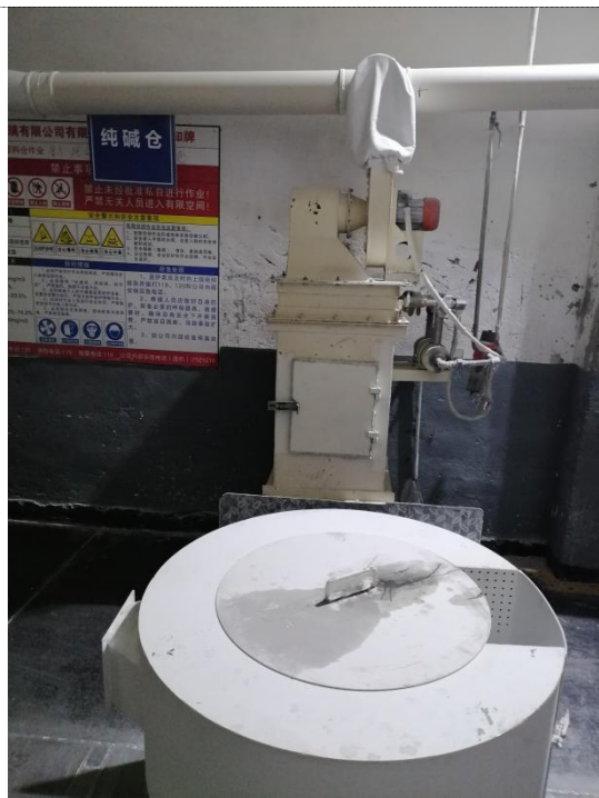
原料上料废气袋除尘器
