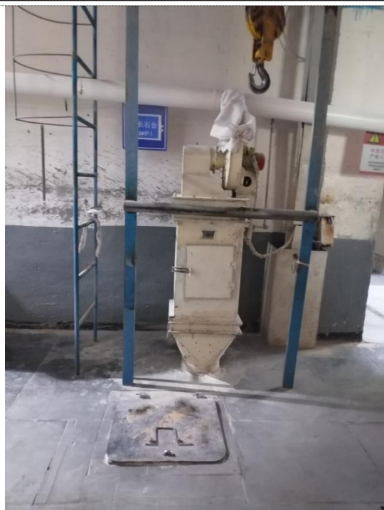
原料上料废气袋除尘器
