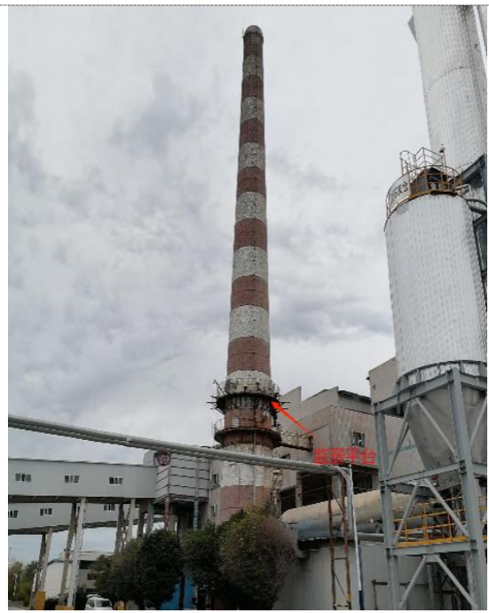
废气排污口采样平台
