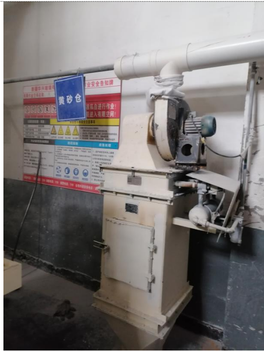
原料上料废气袋除尘器
