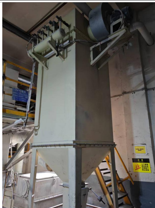
原料上料废气袋除尘器
