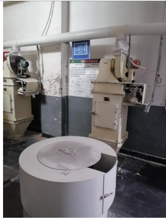
原料上料废气袋除尘器
