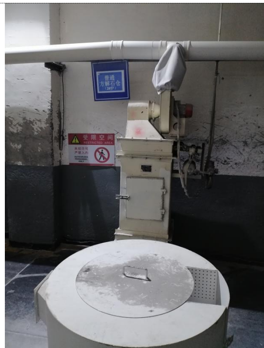
原料上料废气袋除尘器
