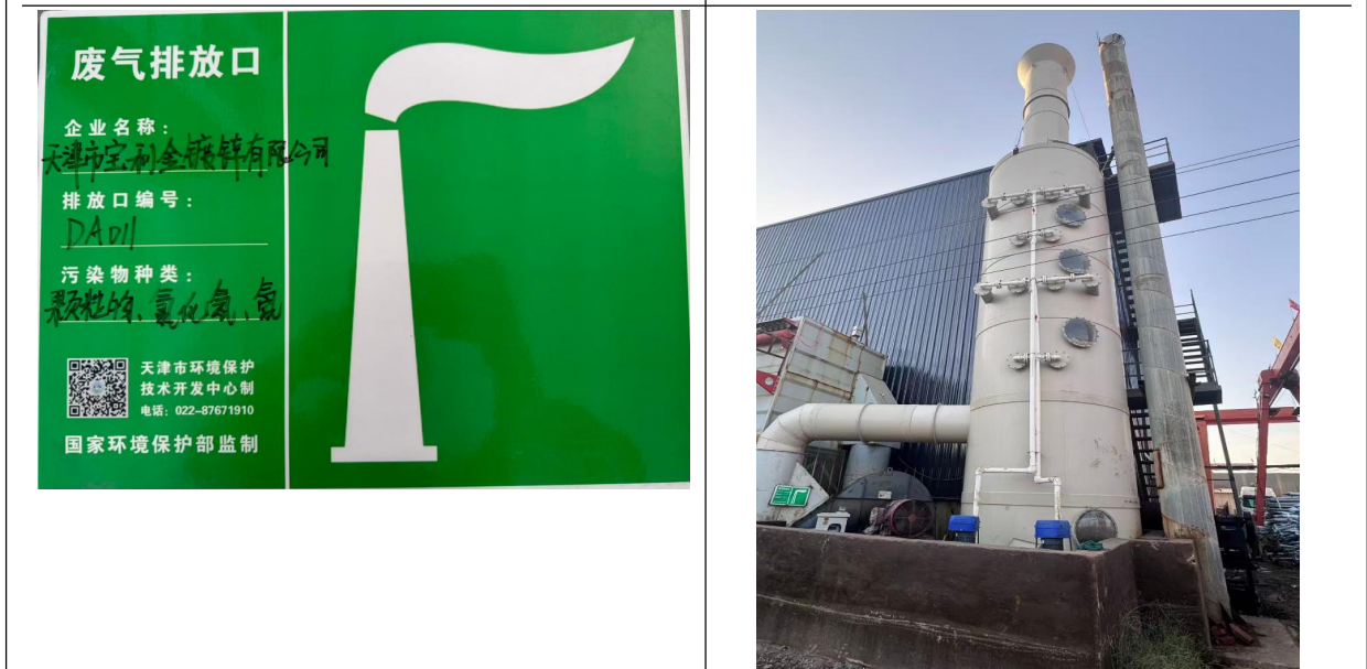
排气筒 P11 标识牌
