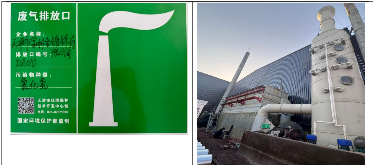
排气筒 P10 标识牌
