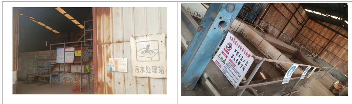
图 2 污水处理设备照片
