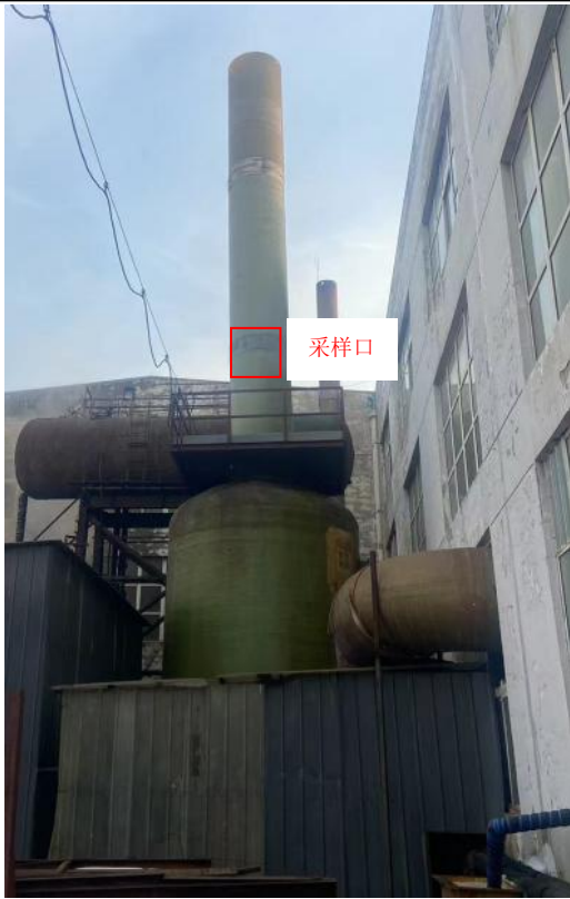
排气筒 P2 (酸雾净化塔)
