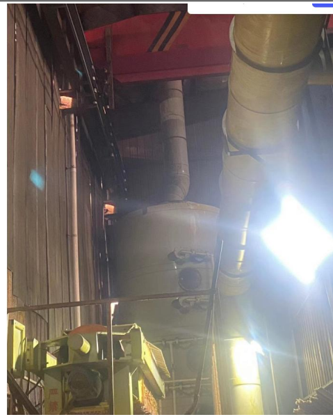
排气筒 P10：酸雾净化塔
