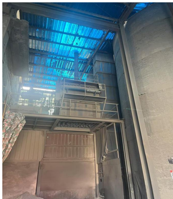
炉渣仓料坑及提升工序布袋除尘器
