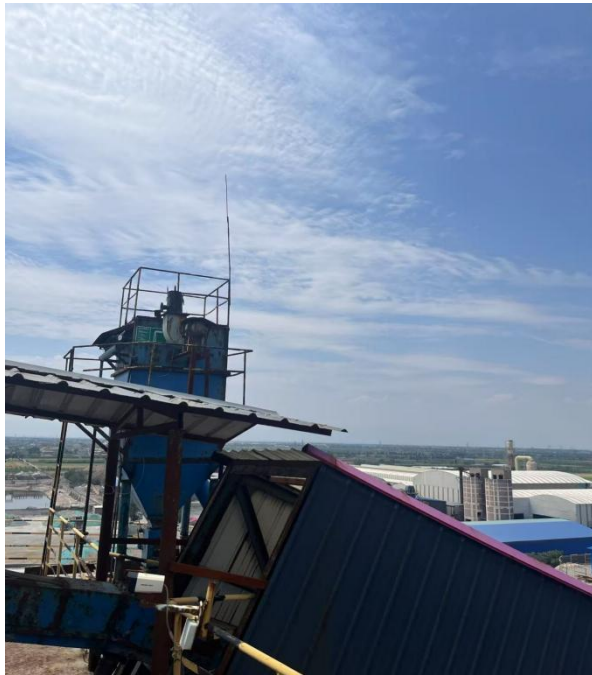
3#水泥仓布袋除尘器
