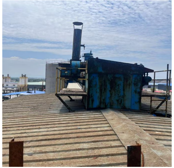
矿粉仓布袋除尘器
