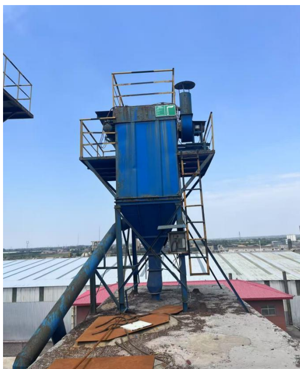
粉煤灰仓布袋除尘器
