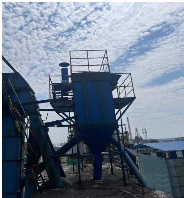
炉渣仓布袋除尘器
