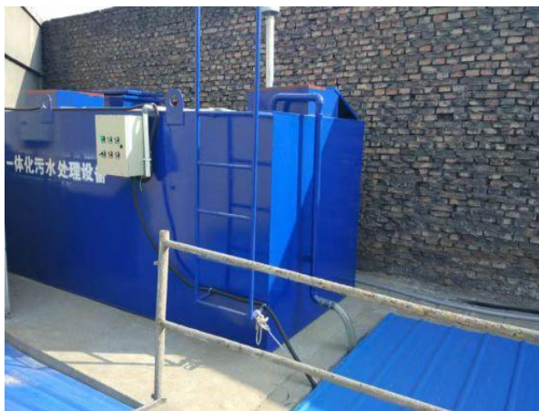
一体化污水处理设施
