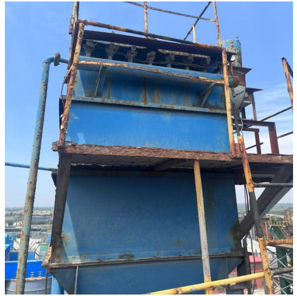
2#水泥仓布袋除尘器
