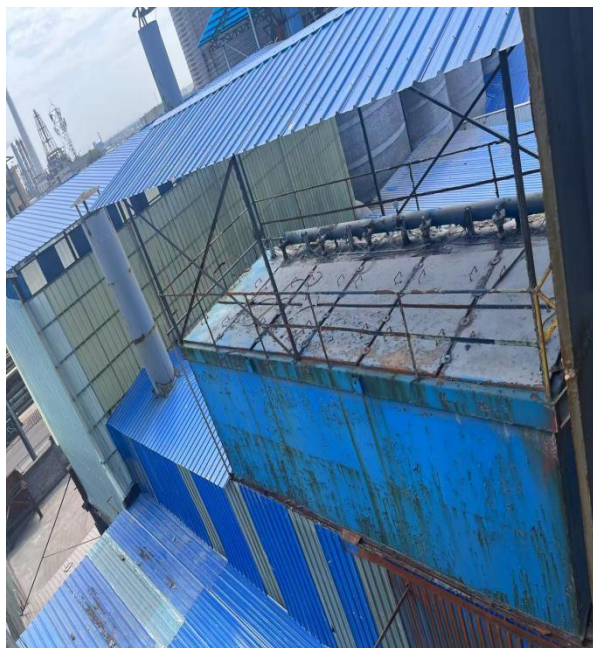
辊压、打散工序布袋除尘器
