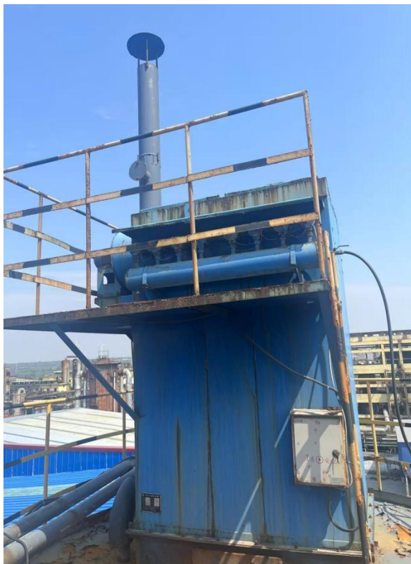
1#水泥进仓布袋除尘器
