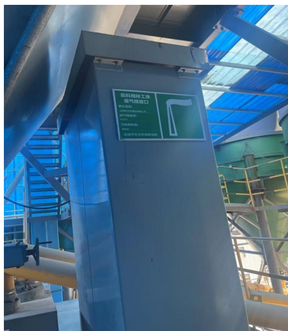
配料搅拌工序、石粉进仓、外加剂粉进仓工序布袋除尘器
