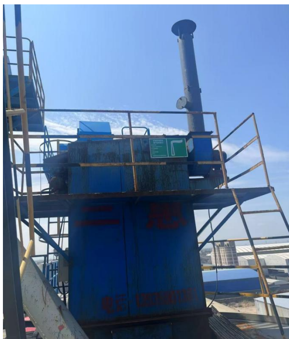
机制砂进仓布袋除尘器
