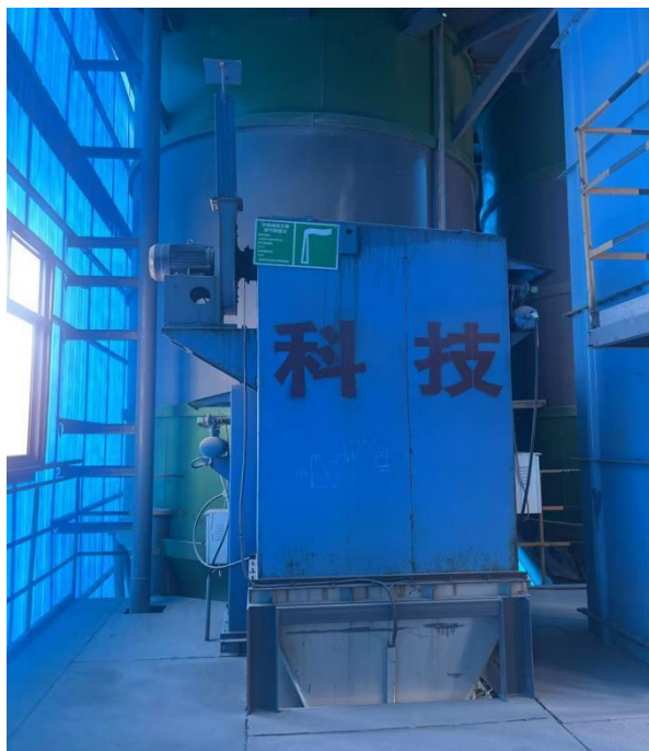
干粉砂浆成品提升、储存、装车工序布袋除尘器
