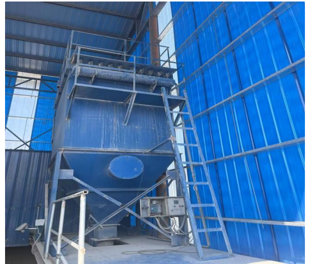
原料给料、破碎、筛分、提升机布袋除尘器
