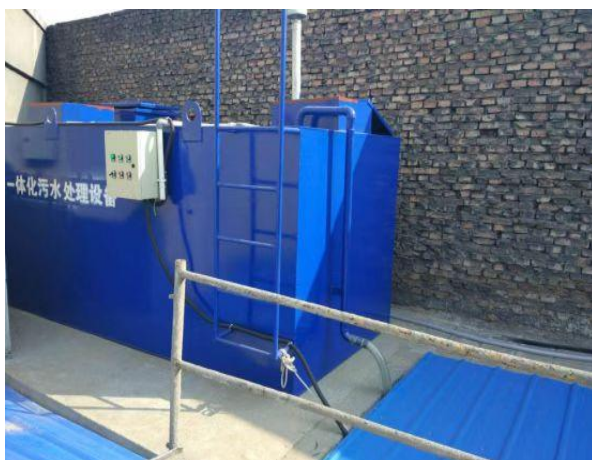
一体化污水处理设施
