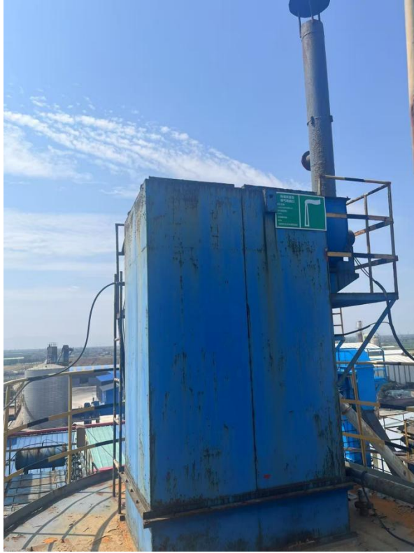
粉煤灰进仓布袋除尘器
