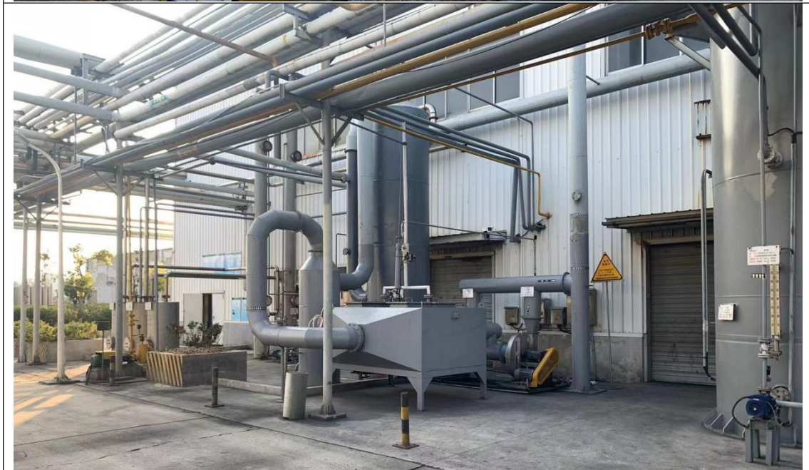
三废处理区：废水处理设施上方均已加盖，废气处理设施已设置围堰，地面完好无明显破损裂痕。
